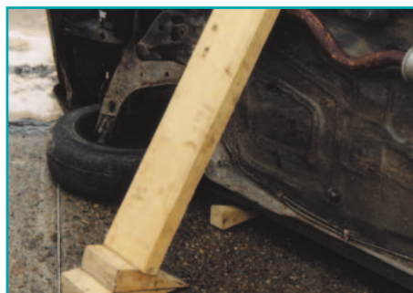
опоры из дерева
