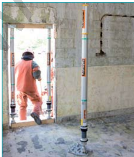
Точечные крепи защищают маршрут выхода
